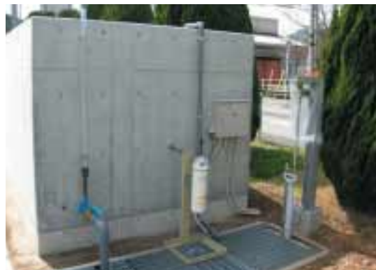
幸田工場排水口各種設備 (油膜検知器、緊急遮断弁および緊急貯留槽)
