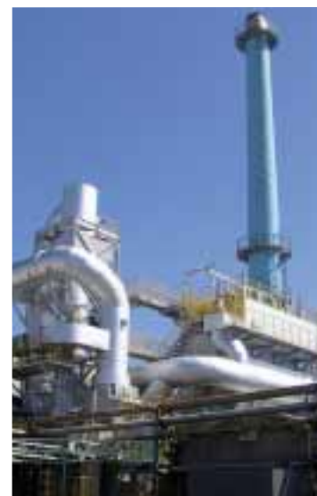
排ガスろ過設備
