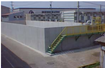
大型末端緊急貯水設備
