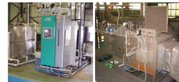
日本軽金属(株)苫小牧製造所 都市ガスボイラー
