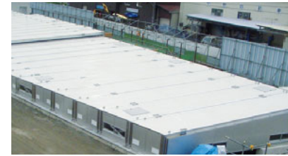
浄水場覆蓋 (株)エヌティシー
