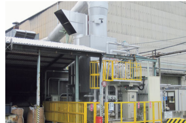
廃熱回収ボイラー[日本軽金属(株)名古屋工場]
