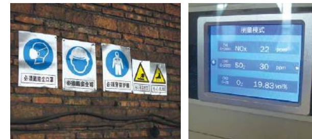
壁に貼付された安全ステッカー
