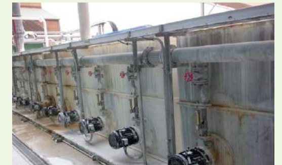
ボイラーから排出されるガスによる中和処理施設
