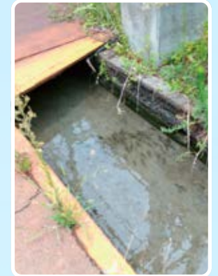
排水路のモニター 日本軽金属(株)清水工場
